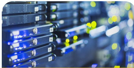
データセンター
